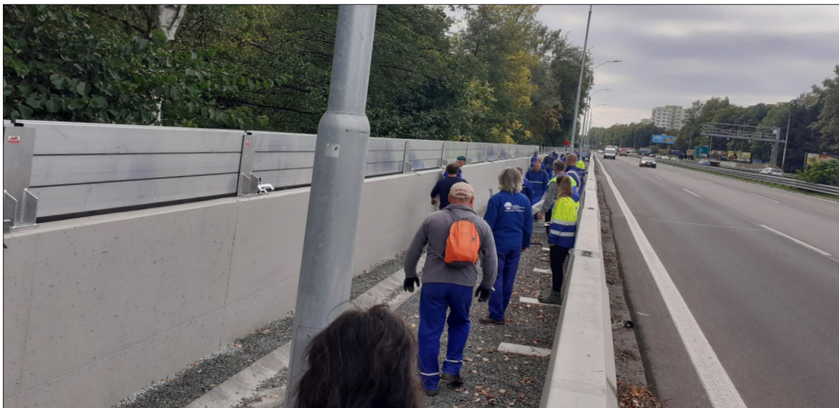
Pohľad na úsek č. 1 v súbehu s rýchlostnou komunikáciou počas skúšky mobilného hradenia.
