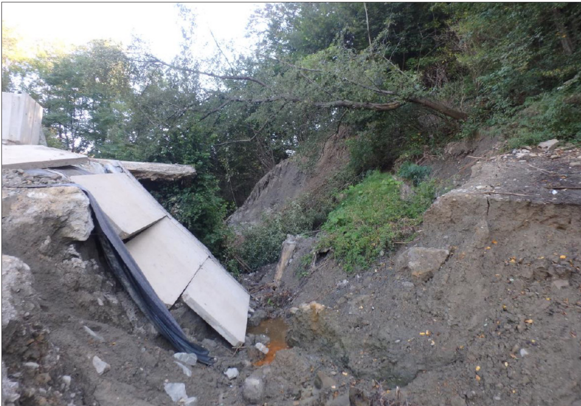
Protržená hráz dolní nádrže 20.8.2020.
